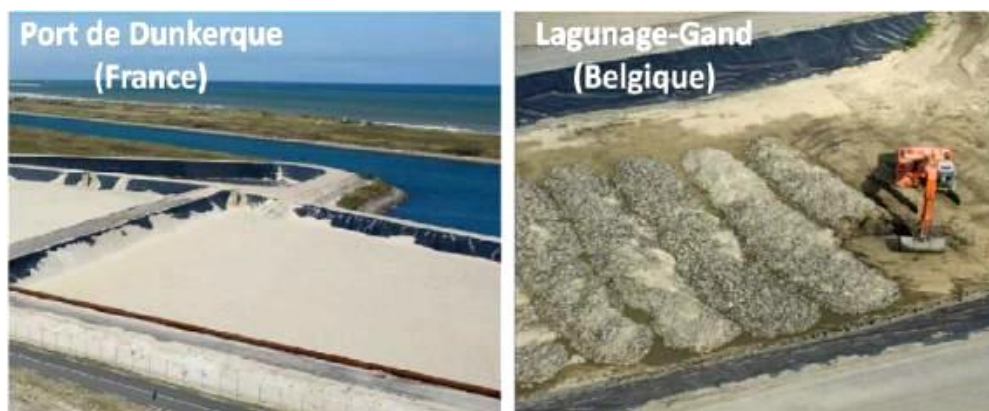
Figure I.20.exemple des bassins de séchage[93]
