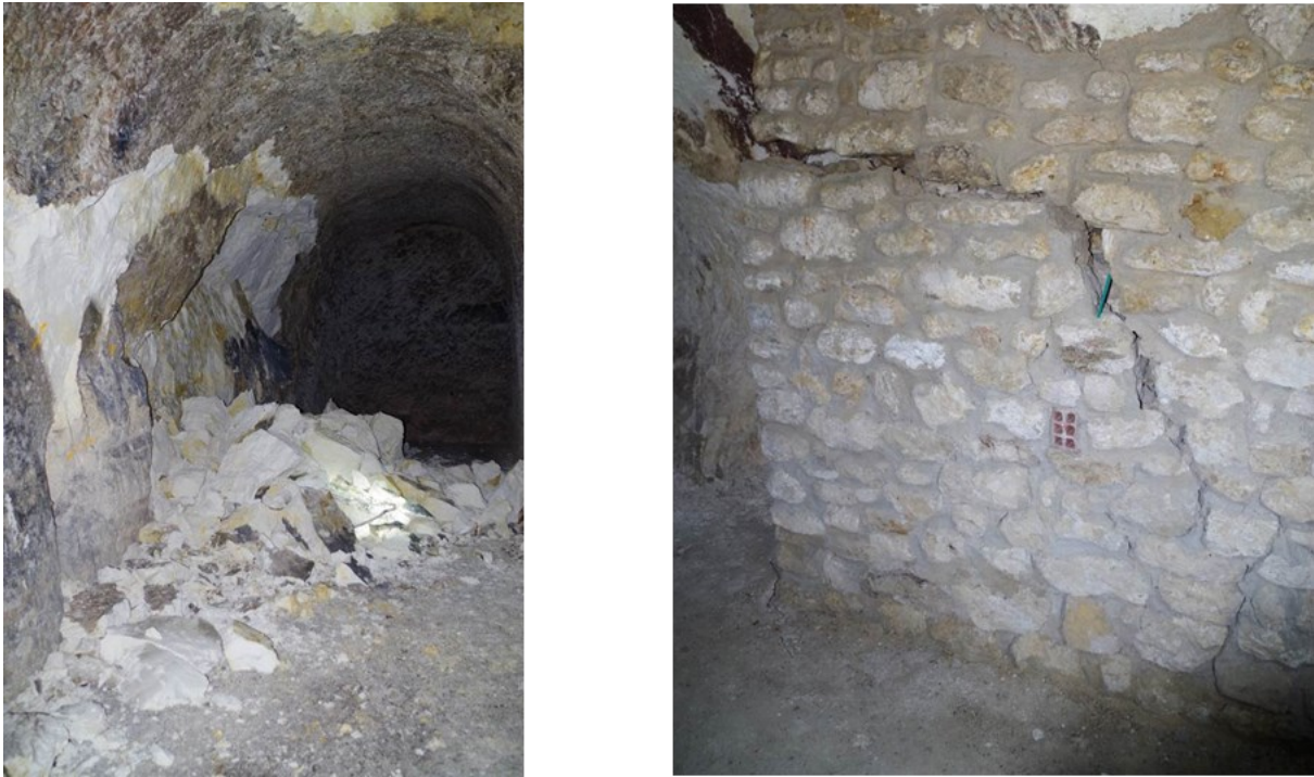
Figure 1.15 Vue des désordres constatés après l'évènement hydroclimatique extrême de juin 2016, affectant une faille (à gauche) et tassant les maçonneries par remobilisation des remblais à la base des galeries (à droite) (Conil 2024)
