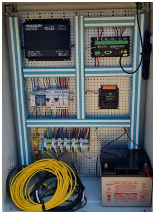
Figure 37 : Coffret avec boîtier d'acquisition
