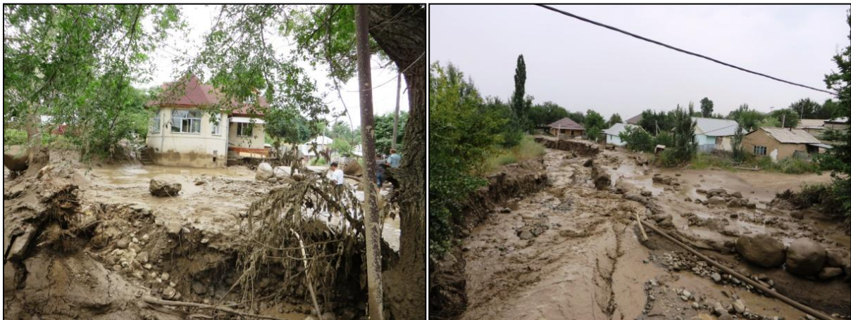
Figure 52: Le lit de la Kargalinka érodé par la lave torrentielle
