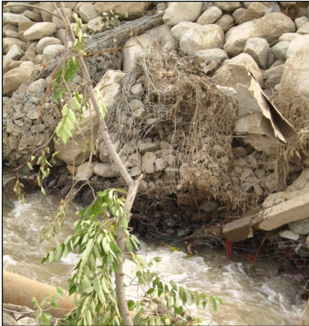
Figure 54: Des gabions déchirés par le flot de la lave torrentielle sur le torrent de Kargalinka
