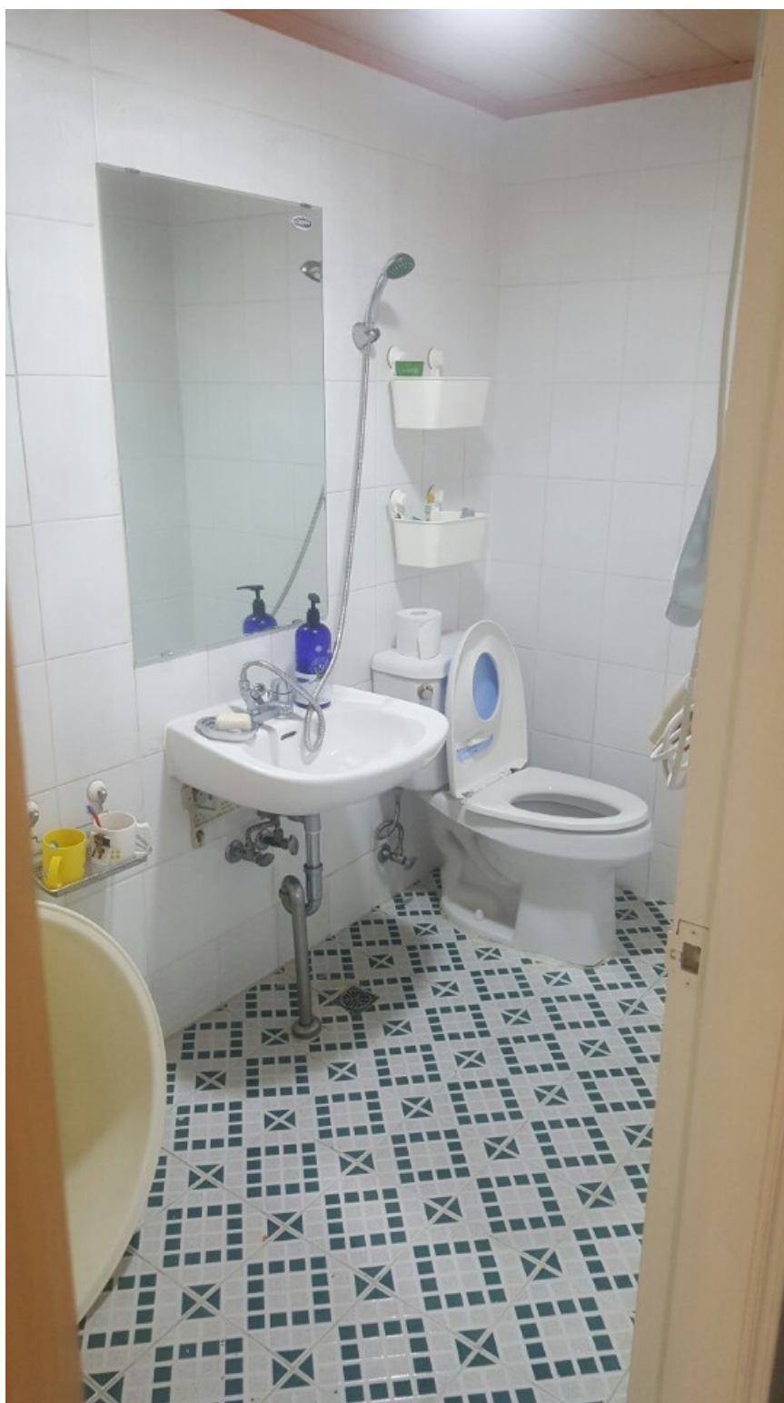
Photo d'une salle de bain « coréenne » dans une villa « standard »
