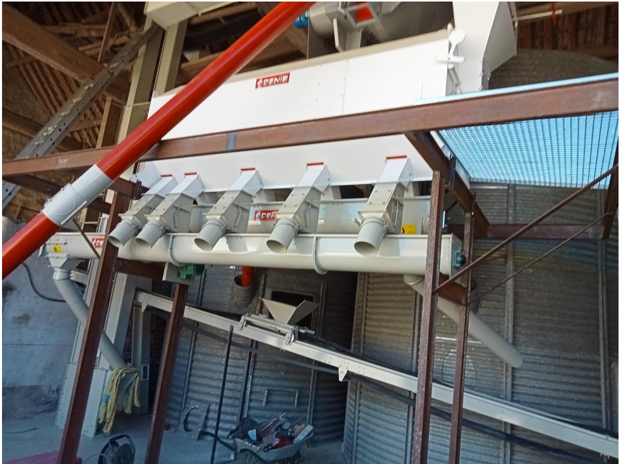
Photographie 28 : le trieur en date du 11 juillet 2022. Sur la droite une grille est en passe d'être soudée pour pouvoir se déplacer autour du trieur
