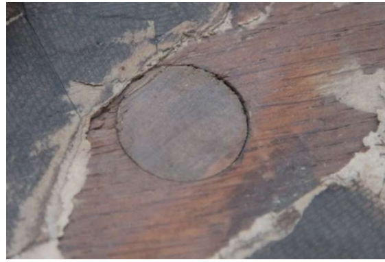
Figure 54 Trou rebouché, près de la porte Notre-Dame
