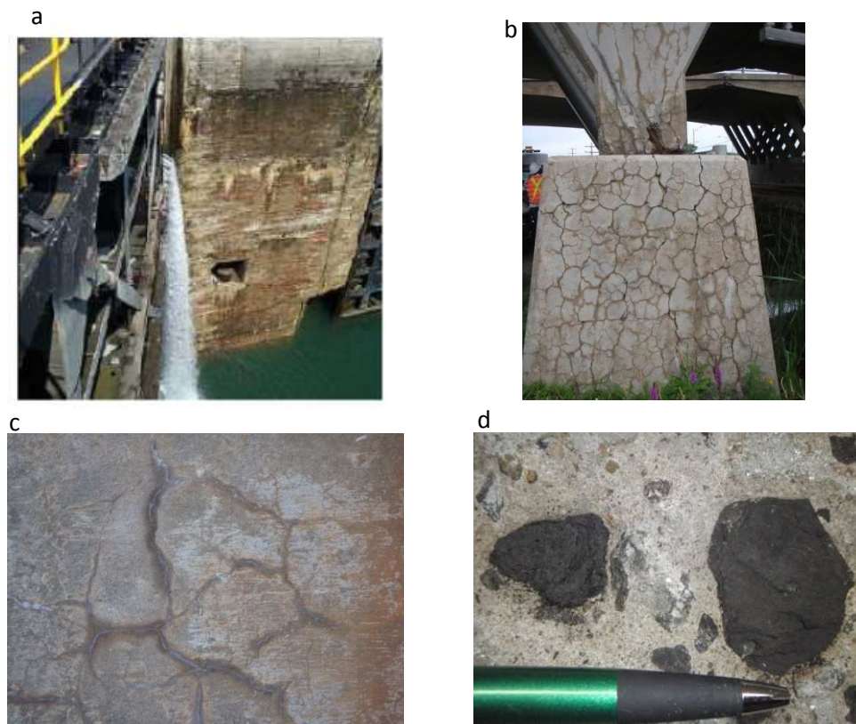
Figure 2.6 Exemple de signes visuels indiquant la présence potentielle de RAS sur un ouvrage (a) blocage des portes d'une écluse, (b) fissuration polygonale, (c) liseré brunâtre autour des fissures, (d) « pop-out »
