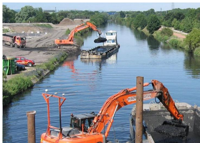
FIGURE 2.4.4: Curage du canal de Lens durant l'été deux mille dix. Crédit : GIS3SP
