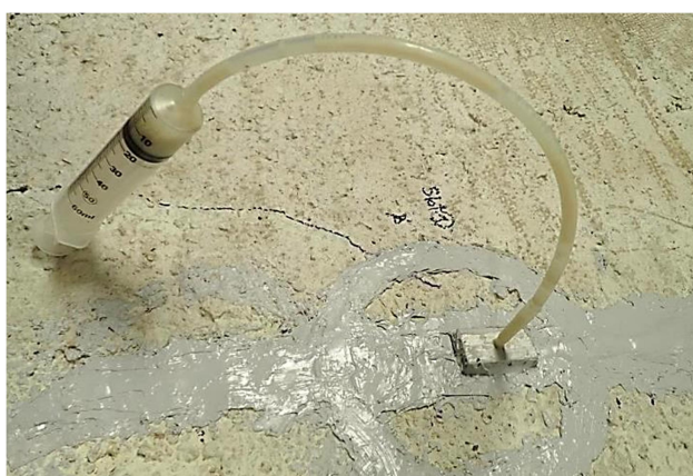
Figure 145 : Sabot d'injection mis en place sur la dalle fissurée à l'aide de scellant polyuréthane.
