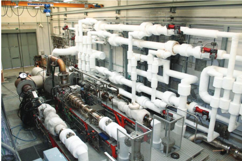
Figure II-4 Le banc de combustion M1 du centre Palaiseau de l'ONERA.
