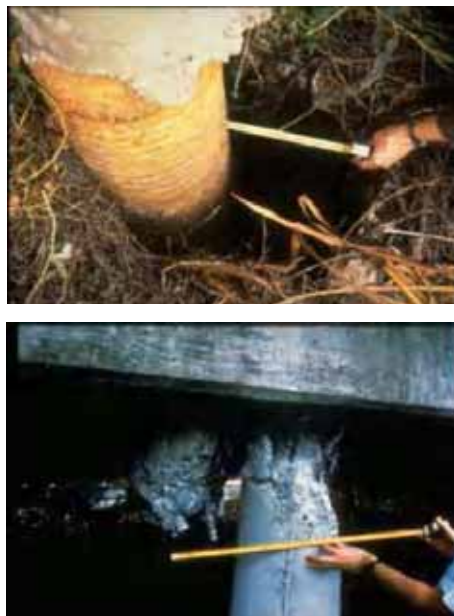
Figure 1.2. Effondrement du pont de Struve Slough près de Wastonville et les dommages subis par ses fondations, (Séisme de Loma Prieta 1989).
