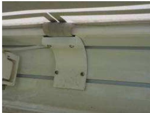
Figure 76 : Boîtier de connexion contenant une diode, la soudure des électrodes planes du panneau photovoltaïque aux câbles
