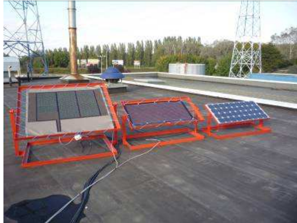
Figure 170 : Comparatif installé sur le toit de l'usine, de gauche à droite : Panneau silicium amorphe PowerFilm Solar ® , panneau silicium amorphe Flexcell ® , panneau monocristallin Cenit 80/80
