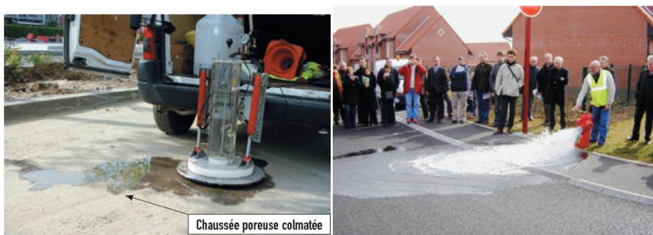
Figure 16 : Démonstration de la perméabilité des enrobés poreux sur la résidence Delestraint, Lambres-lez-Douai
