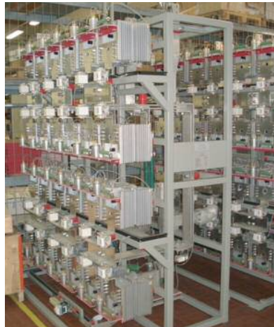
Figure 3.1 : Redresseur de sous-station d'alimentation en tension continue de 1,5 kV [5]
