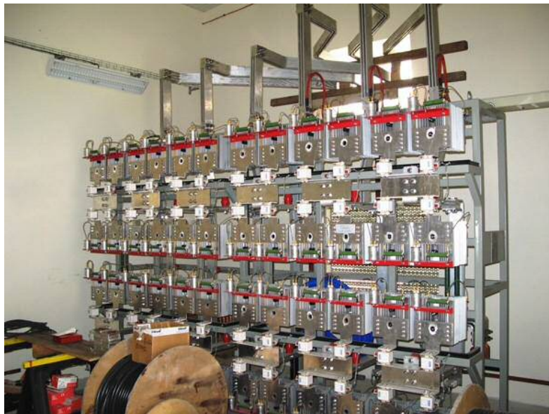
Figure 1.13 : Exemple de redresseur utilisé dans une sous-station en tension continue de 1,5 kV
