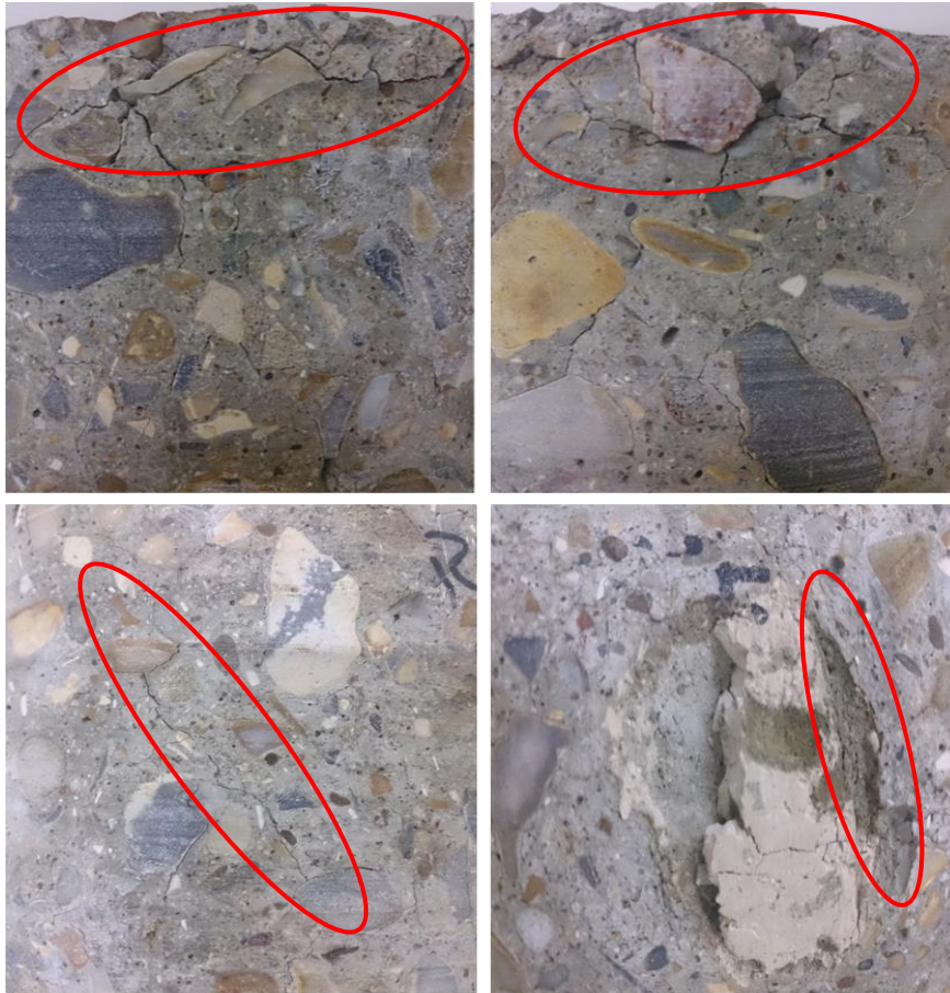
Figure 109: Dégradation et fissuration du béton B2 après cinq mois de cycles immersion/séchage à 60°C
