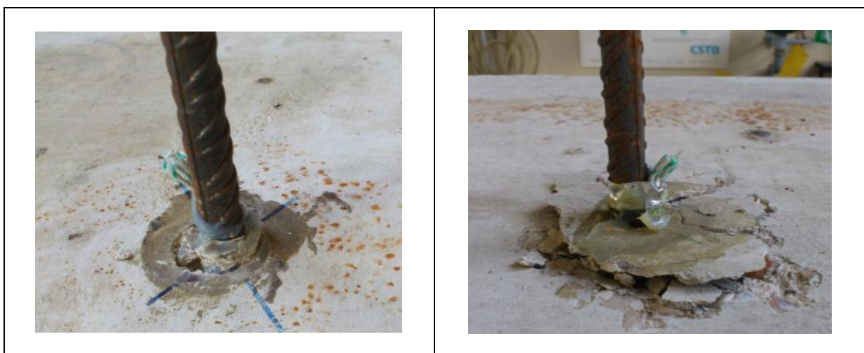
Figure 186: Photos de ruine par arrachement et par formation d'un cône de béton
