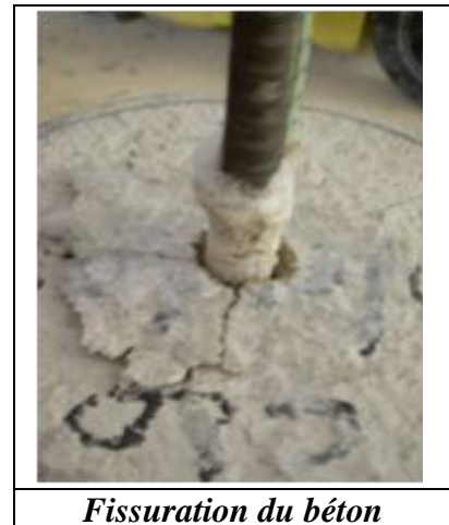
Figure 93: Fissuration en surface du béton
