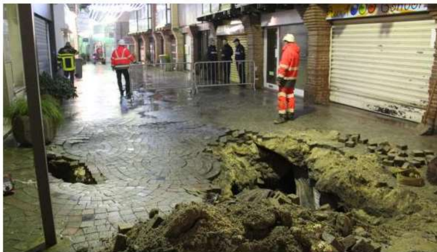
Figure 1.36. Surface damage at Boisselle, Lille – Journal : La Voix du Nord, 2015
