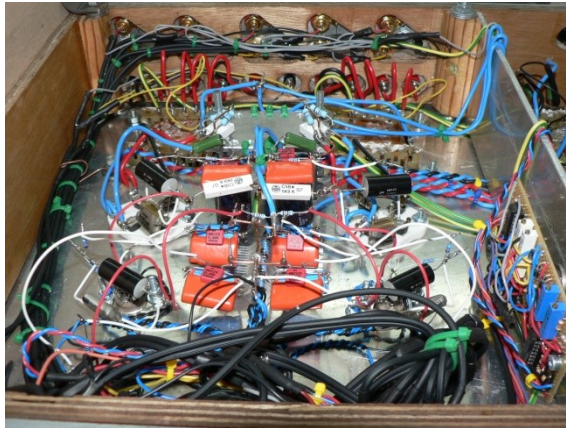
Figure 4. Connexion par câbles
