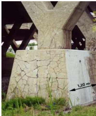
Figure 1-1 – Exemple de béton dégradé par l'alcali-réaction
