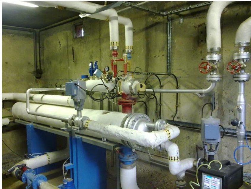
FIGURE 2.2 Conduite dans une sous-station
