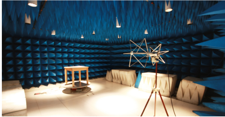
FIGURE 1.25 – Chambre en configuration semi-anéchoïque (IEMN)
