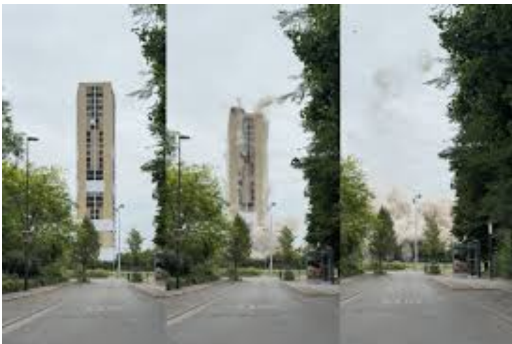
Figure 34 : foudroyage de la tour Kennedy à Loos en juillet 2025. © Actu 2025.
