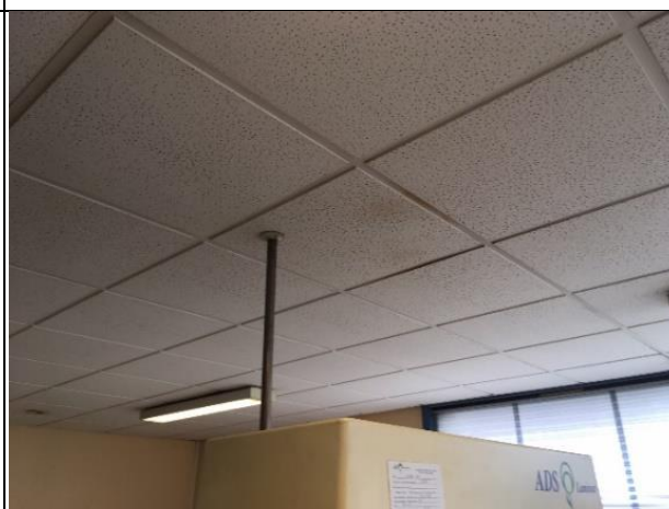
Photo 4 : Présence de tâches de corrosion au plafond situées au-dessus de la hotte filtrante provoquées par le recyclage de l'air
