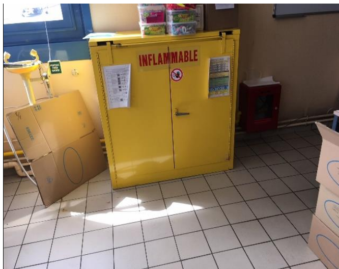
Photo 1 : Stockage des agents chimiques et CMR dans une armoire métallique non ventilée sous clé
