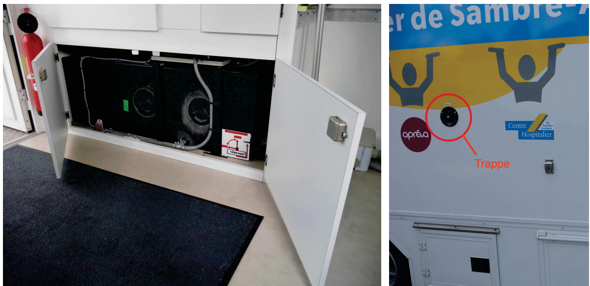
Figure 16 : Installation d'eau et trappe de remplissage
