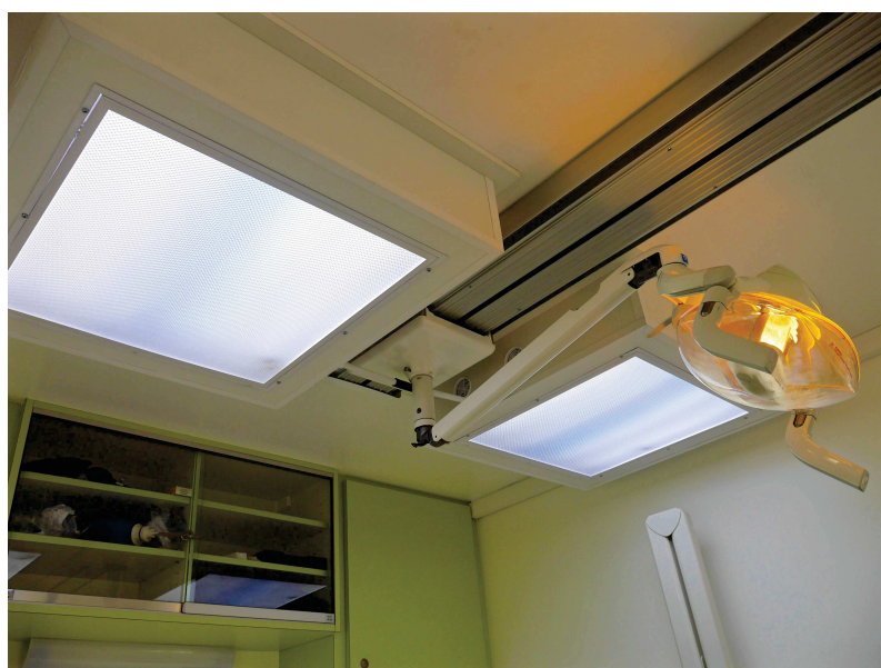
Figure 29 : Eclairage du cabinet dentaire de l'unité mobile : scialytique sur rail et plafonnier
