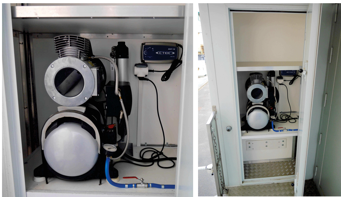
Figure 28 : Compresseur et compartiment d'installation extérieur
