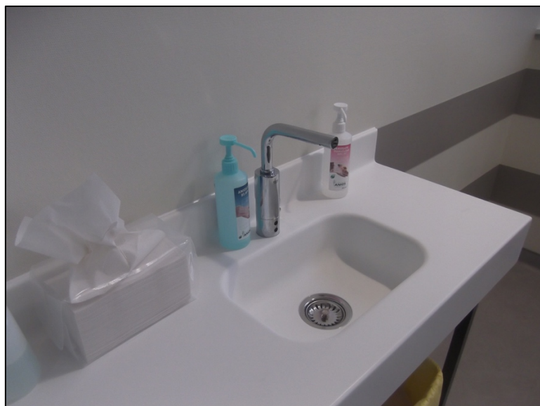
Figure 11 : Exemple de poste de lavage non isolé du plan de travail en aile Ouest
