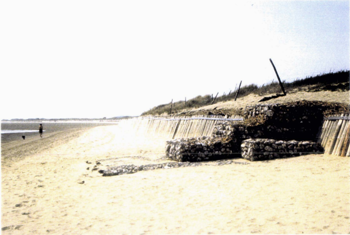
Fig.62: La digue du Parc ornithologique du Marquenterre, essai d'une protection par des poches grillagées remplies de galets.(photo., P.Picouet, 2 / 05 / 1995 )
