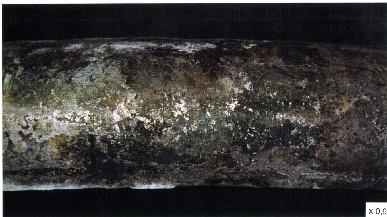
Figure 4-9 : examen macroscopique du tube en Sanicro 38 (durée de service : 36673 heures) ; Chaudière 1 de l'usine de Saint-Ouen.
