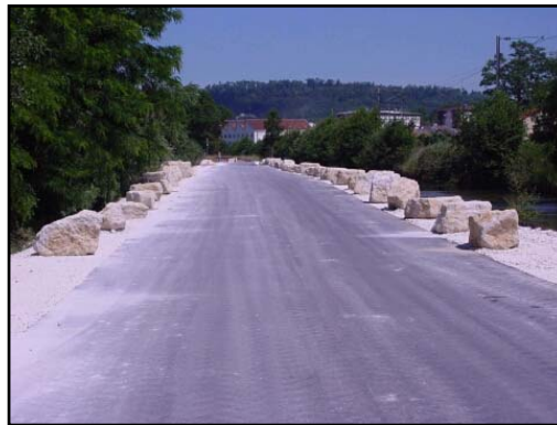
Photo 1-4: les différentes étapes de la construction de la route de démonstration du procédé Revasol® à Dombasles.
