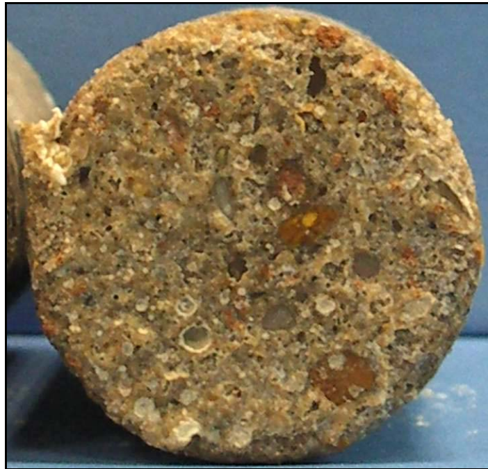
Photo 4-11: détail de la dégradation de la surface supérieure d'un échantillon de mortier MS33 0.315/4.
