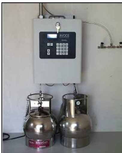
Figure II-2.4 : Préleveur AVOCS en fonctionnement dans 3 stations MERA
