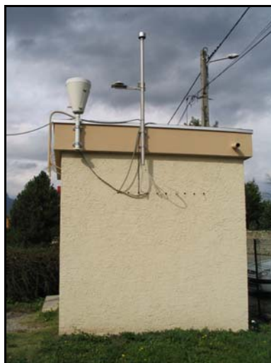
Figure III.8 : Station de mesure des COV de Champagnier
