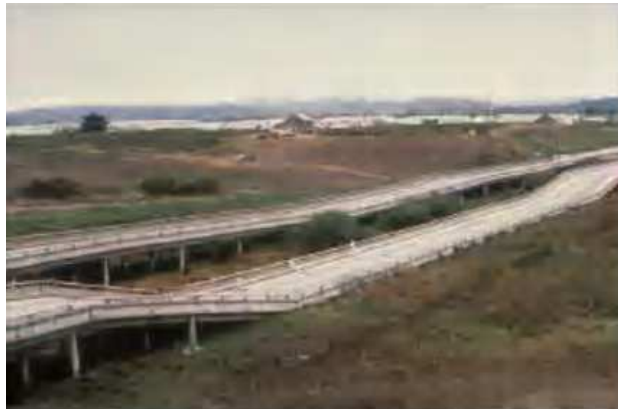
Figure 1.10. Dommages de pieux inclinés au niveau de la connexion avec leur chevêtre (Séisme de Loma Prieta 1989).
