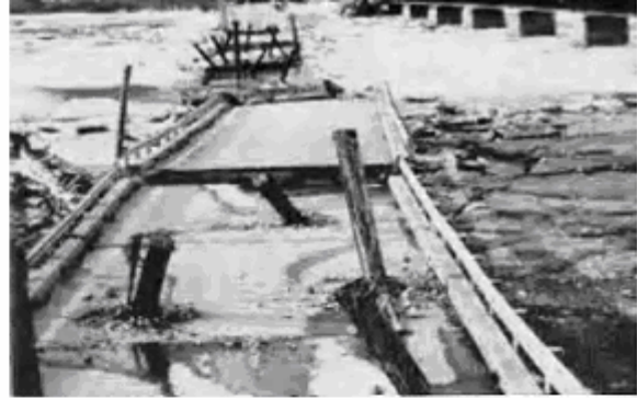
Pénétration des pieux inclinés dans le tablier causant l'effondrement de pont Twentynine Mile.
