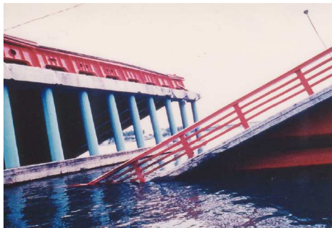
Figure 1.9. Effondrement du pont de Showa par la liquéfaction de sol (Séisme de Niigata 1964).
