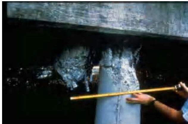
Figure 1.11. Effondrement du pont de Struve Slough près de Wastonville et les dommages subis par ses fondations, (Séisme de Loma Prieta 1989).
