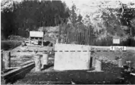
Inclinaison de 15° induit par la liquéfaction de sol autour des pieux de pont 605A sur la rivière de Snow.
