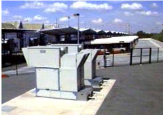
Photo 2-12 : Installations GNV à Poitiers comprenant les 2 modules de compression et les 22 emplacements de remisage extérieur. [SWC.II 12]
