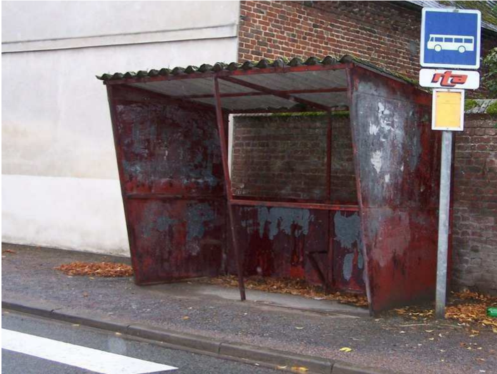
L'abri bus de Brissy-Hamégicourt : l'aspect général, l'absence de siège et sa faible protection face aux intempéries illustrent l'opinion des élèves. Photo : Stéphane GODEFROY, 2006.
