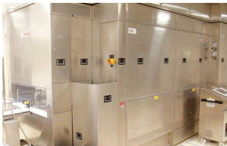
Figure 4 : Le tunnel de dépyrogénéation.
