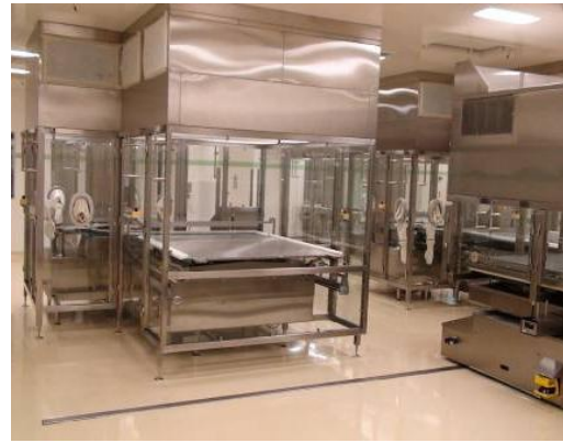
Figure 17 : Table de déformatage.
