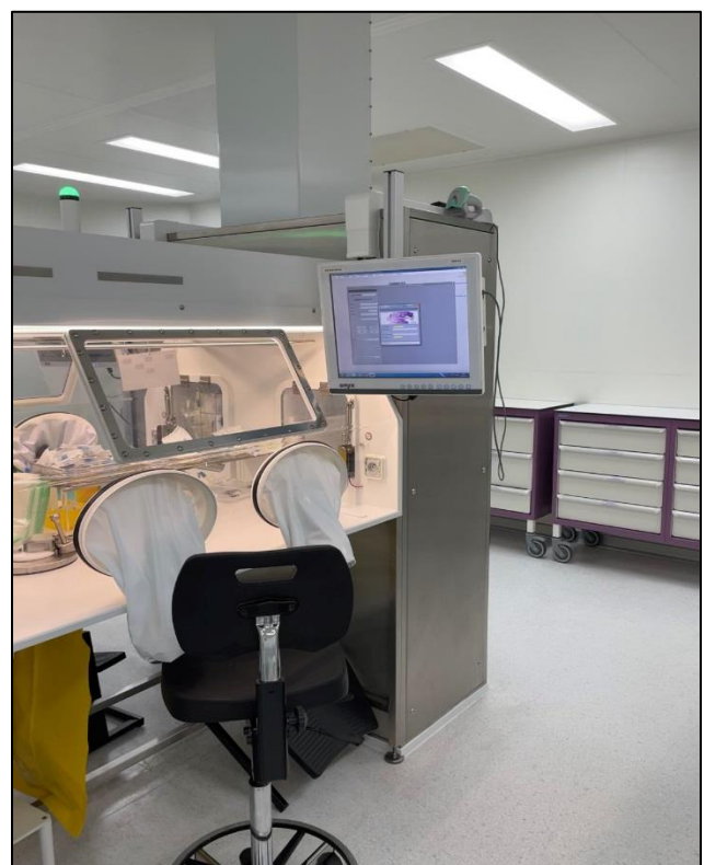
Figure 5 : Poste de préparation de l'URCC du CHU de Lille
