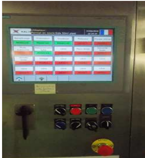
Figure 52 : Automate de la remplisseuse
