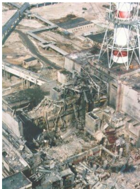
Figure 9 : Bâtiment détruit de la tranche 4 de la centrale nucléaire de Tchernobyl (16)
