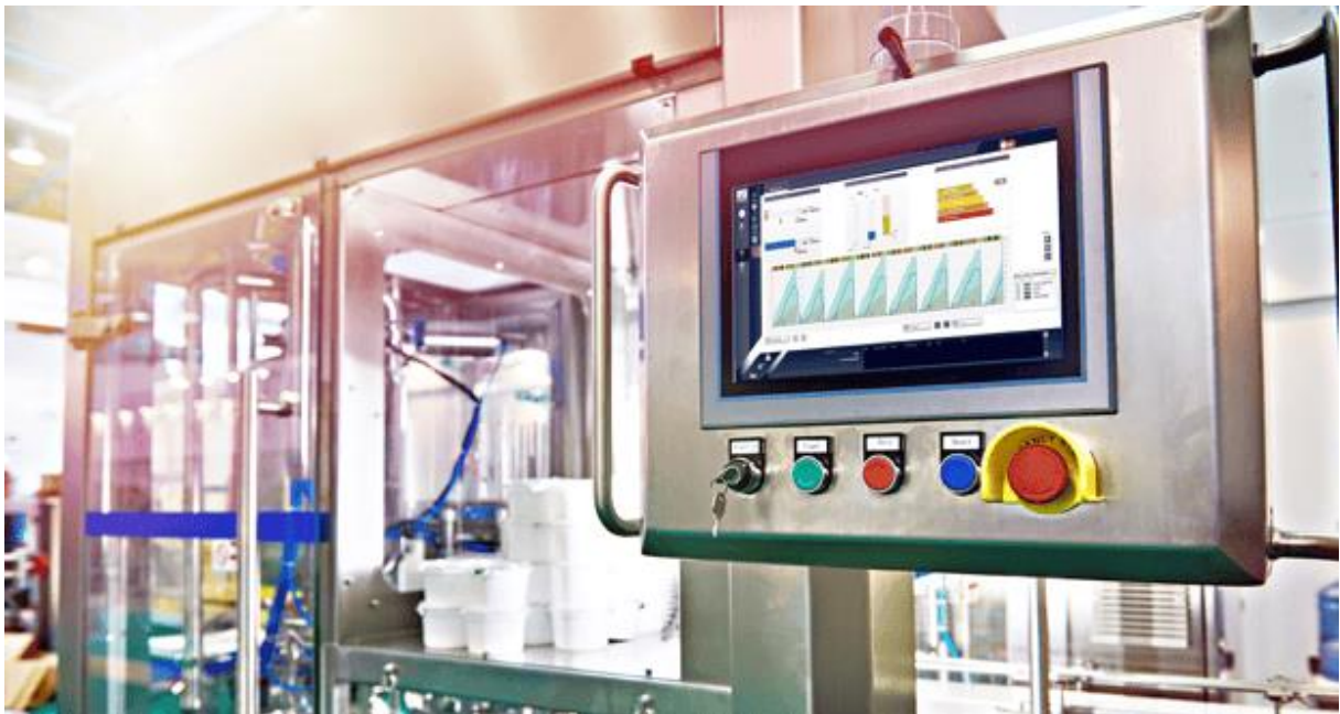
Figure 16 : Photo d'un SCADA (53)
