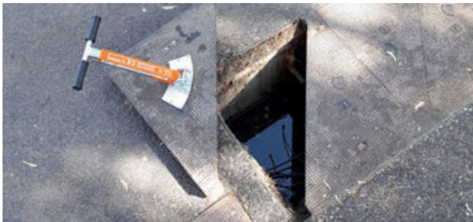
Figure 42 : Exemple d'un coffret technique rempli d'eau stagnante (128)
