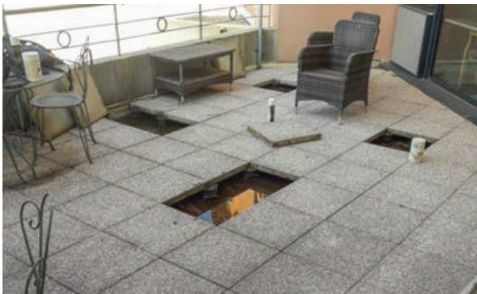
Figure 39 : Exemple d'une terrasse sur plots avec une stagnation d'eau sous les dalles (128)
