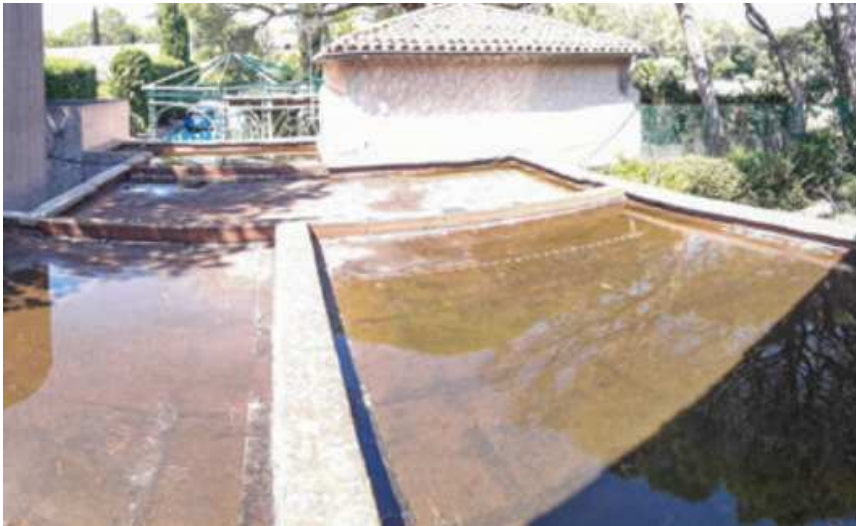
Figure 41 : Exemple d'une terrasse-toit inondée (128)
